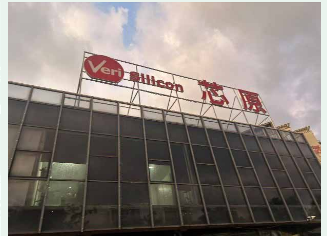
◆ 广告牌稳固检查
